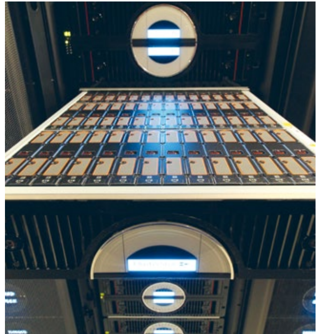
Abb. 1: Das DKRZ will seinen Nutzer:innen zukünftig einen Speicherbereich des offenen Standards S3 zur Verfügung zu stellen, wofür die Festplatten des stillgelegten Rechners „Mistral“ weiter genutzt werden sollen.
