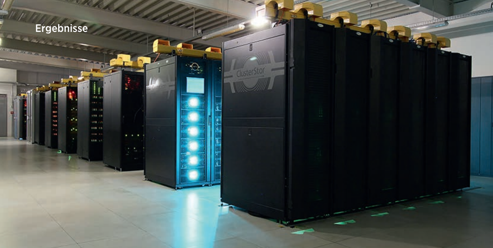
Abb. 1: Der Endausbau des dritten Hochleistungsrechnersystems für die Erdsystemforschung „Mistral“ wurde am 28. Juni 2016 von Atos/Bull ans DKRZ übergeben und stand den Nutzern ab dem 4. Juli zur Verfügung.
